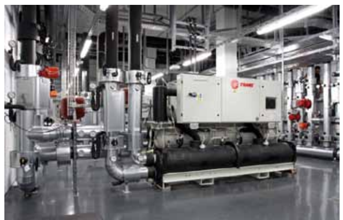
Kältemaschine: Optimale Lösungen vereinen geringe Kältemittelmengen mit hoher Effizienz – unabhängig vom Kältemittel
