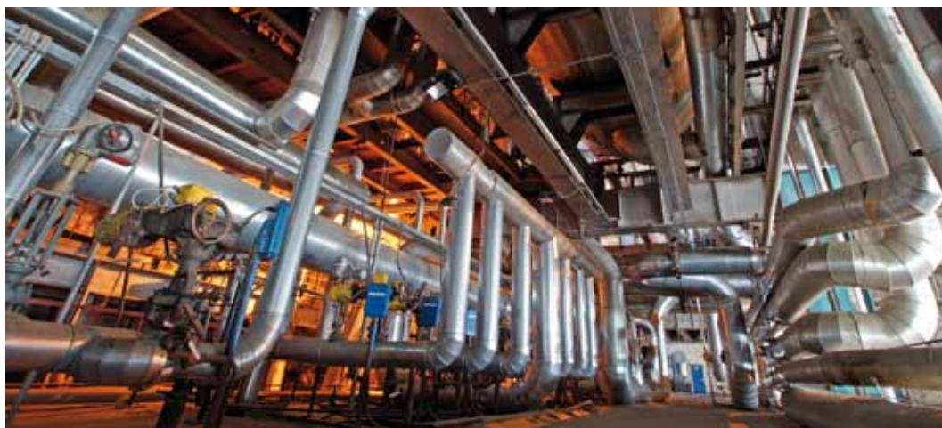
Bei gewachsenen Systemen stellt sich häufig nur die Frage nach technischer Funktion, nicht nach Effizienz und Kosteneinsparungen im täglichen Betrieb
