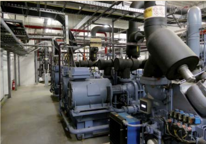
Das Potenzial zur Effizienzsteigerung von Kälteanlagen liegt bei bis zu 20 Prozent
