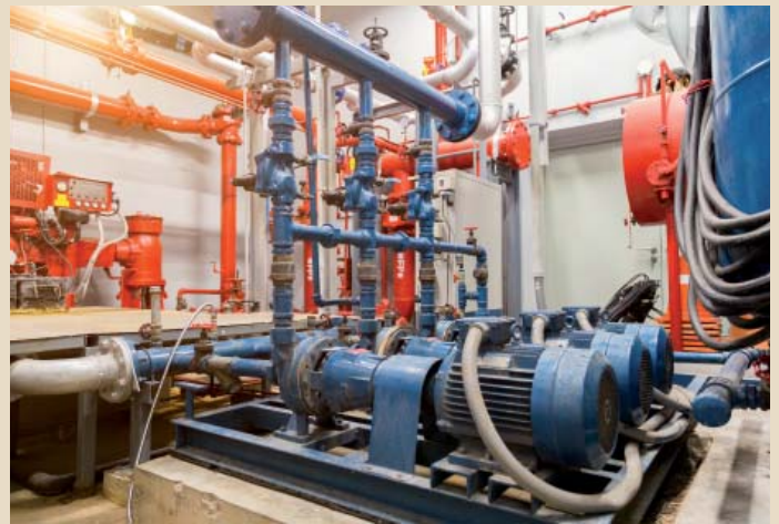
Durch einfache Maßnahmen lässt sich z. B. im Bereich der Pumpen viel Energie einsparen
